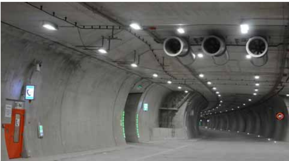
Sicherheitsinstallationen im Tunnel Pörzberg
