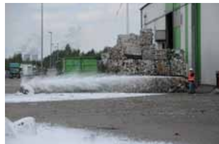
zusätzlich zu ortsfesten Löschbereichen Betrieb von Handleitungen möglich mit Wurfweiten bis zu 20m
