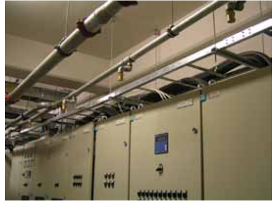
Schaltanlagen mit Düsenrohrnetz
